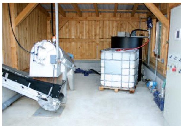
Instalação ROS 3Q/280 completa em 12 m²
