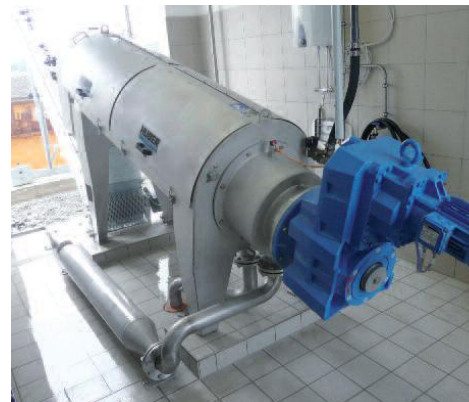
Instalação fixa para desidratação de 140 Kg. MS/h
